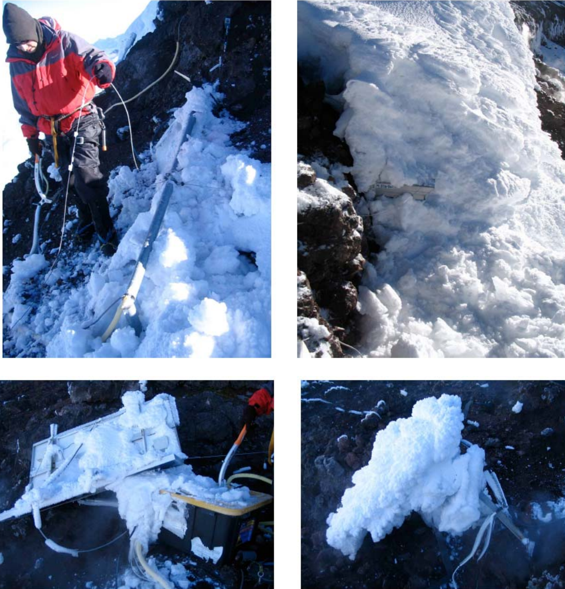
Figura No. 8 Fotografías que muestran los daños sufridos por los diferentes componentes de la cámara de video instalada en el cráter del volcán Cotopaxi
